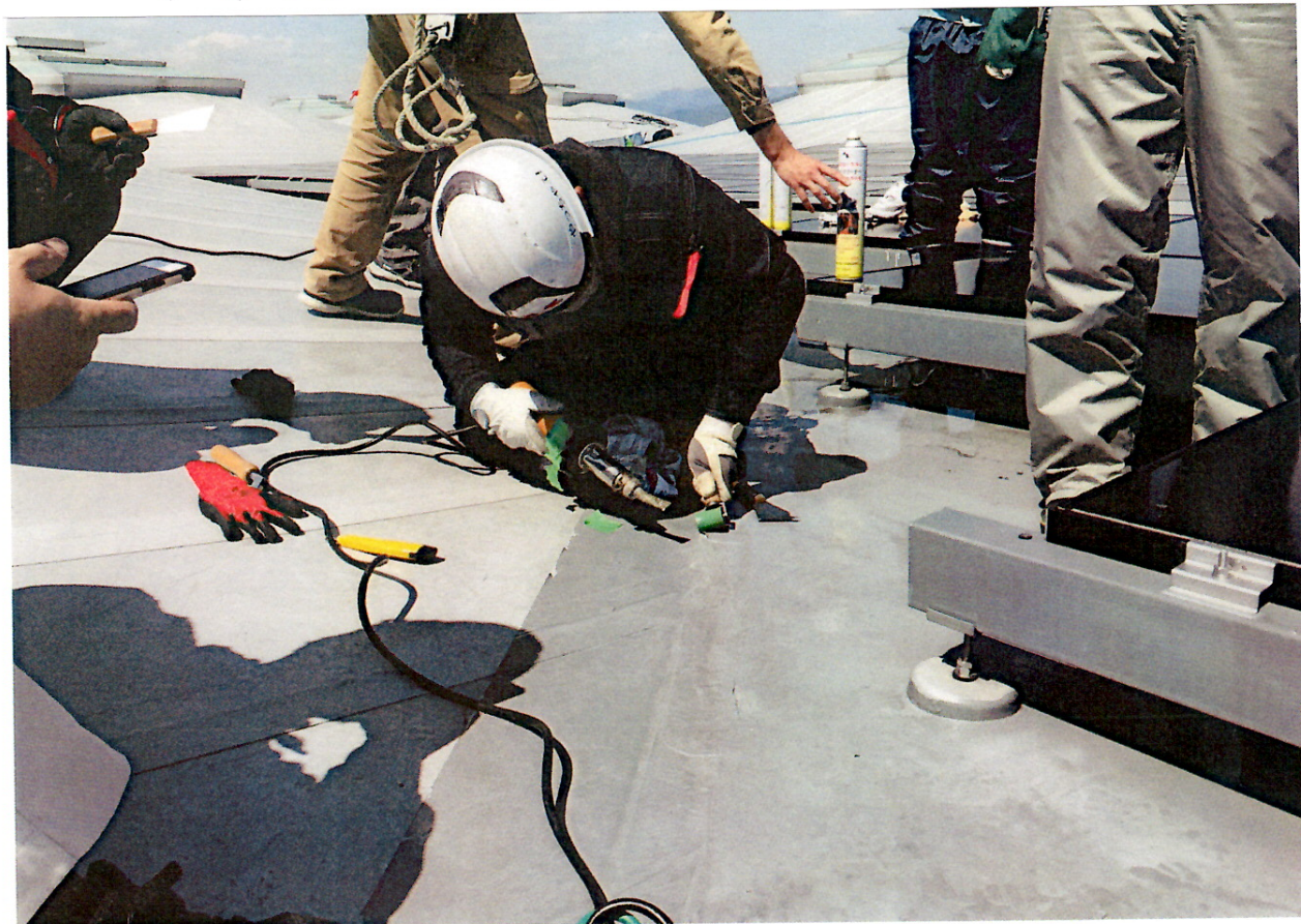
屋根面の不良による雨漏りを発見。メディアコスモス東屋根の防水テープを修理中。(写真・市民参画部)
