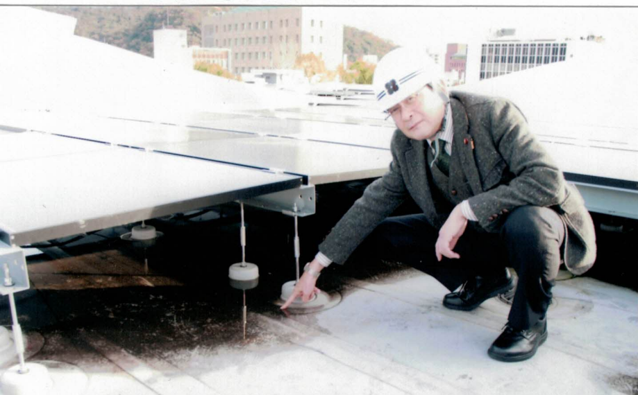
メディアコスモス屋上で水溜りを視察点検。一次補修後も水溜りは未解決。12月9日
